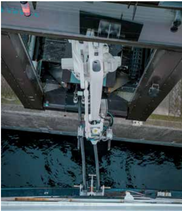
T v: Så fort färjan lägger till vid kaj efter den 20 minuter långa överfarten, laddar roboten batterierna. Släcka alla lampor i Helsingör för nu laddar Aurora, brukar Christian Andersson skämtsamt säga.
